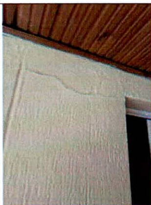
Fotografía 12. Fisuras identificadas en los muros interiores del apartamento 202.
