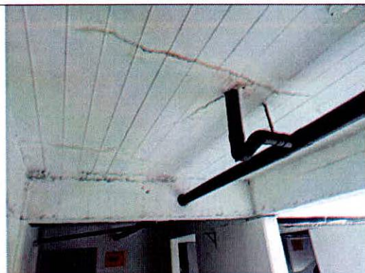
Fotografía 16. Humedad y filtraciones de agua en la parte inferior de la placa de entrepiso del sótano de parqueaderos.
