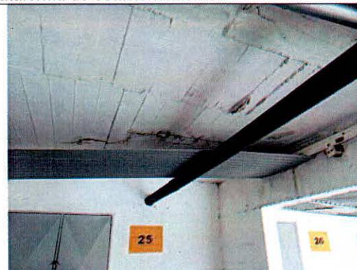
Fotografía 17. Humedad y filtraciones de agua en la parte inferior de la placa de entrepiso del sótano de parqueaderos.
