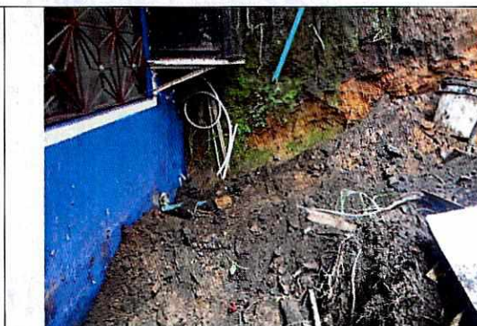
Fotografía 6. Talud de corte de la vivienda en la Calle 156 No 87B - 08, en el Barrio Tuna Alta Sector Bella Vista.
