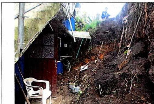
Fotografía 5. Talud de corte de la vivienda en la Calle 156 No 87B - 08, en el Barrio Tuna Alta Sector Bella Vista.
