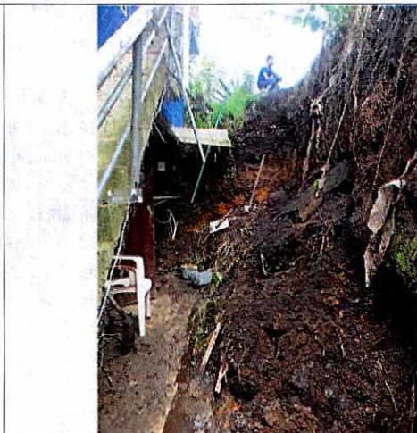
Fotografía 4. Talud de corte de la vivienda en la Calle 156 No 87B - 08, en el Barrio Tuna Alta Sector Bella Vista.
