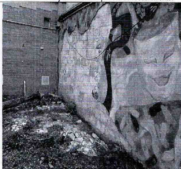
Foto 22. Desprendimiento parcial del pañete.
