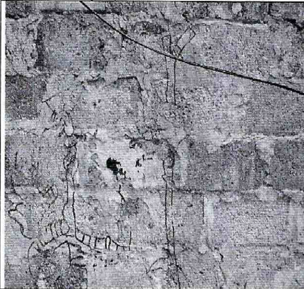
Foto 17. Agrietamientos y daño fuerte del muro de lindero.
