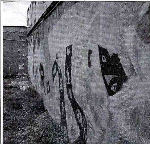
Foto 15. Ligera pérdida de verticalidad del muro.
