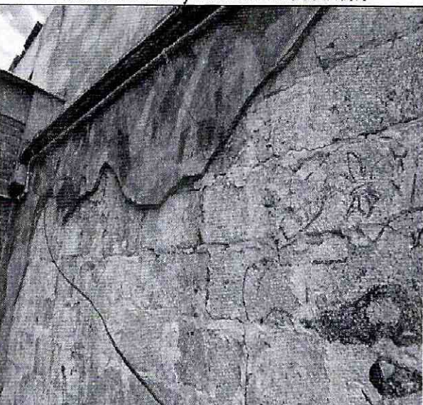
Foto 16. Grietas, fisuras y desprendimiento del pañete.
