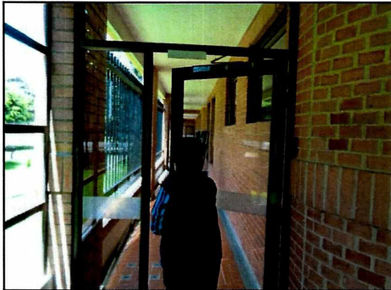
Fotografía 2. Estado de la los muretes de fachada del costado sur del edificio Monterrey evidenciada el día 20 de Febrero de 2018.
