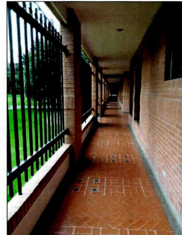
Fotografía 3. . Estado de la los muretes de fachada del costado sur del edificio Monterrey evidenciada el día 7 de Febrero de 2019.
