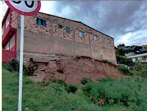
Fotografía 8. Talud de corte realizado en el predio P2.
