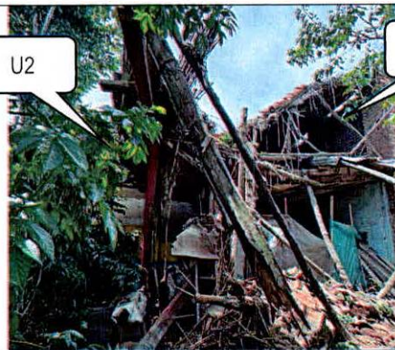
Figura 2. Colapso Parcial de la Unidad Habitacional U1
