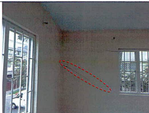
Fotografía 9. Afectaciones en muros interiores del segundo nivel de la edificación.
