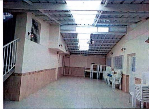
Fotografía 11. Daños en muros interiores del segundo nivel de la edificación.
