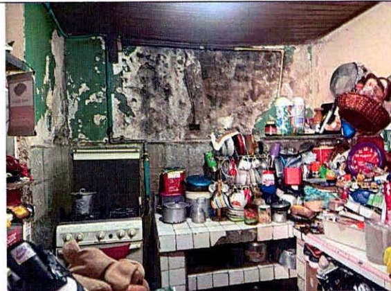
Fotografía No. 2. Humedades en la cocina
