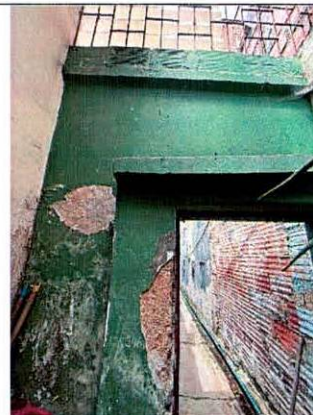
Fotografía No. 4. Humedades en muros perimetrales
