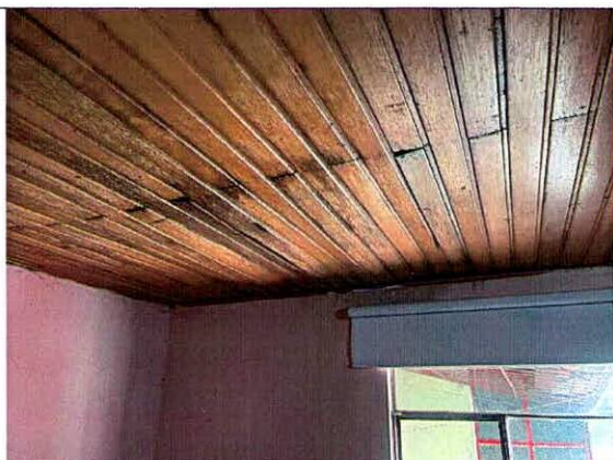
Fotografía No. 5. Filtraciones en el cielo raso
