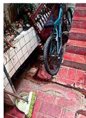
Fotografía No. 6. Filtraciones en la vivienda
