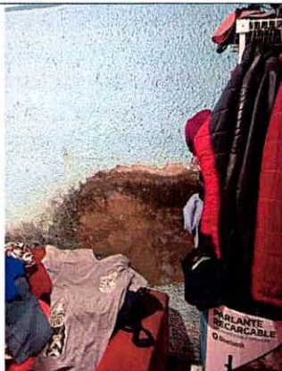
Fotografía No. 3. Humedades en la habitación
