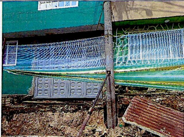
Fotografía No. 6. Vista del poste con pérdida de verticalidad y el soporte instalado frente a las viviendas evaluadas.
