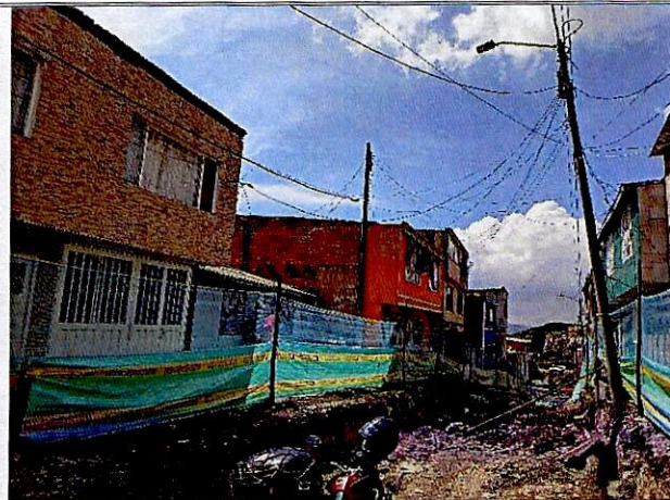
Fotografía No. 4. Vista de las excavaciones y el poste con pérdida de verticalidad frente a las viviendas evaluadas.
