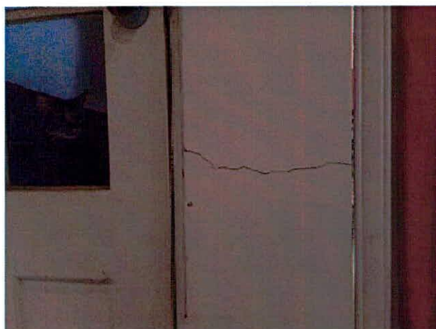
Fotografía 15. Daños localizados en el apartamento 202 localizado en el predio P1.
