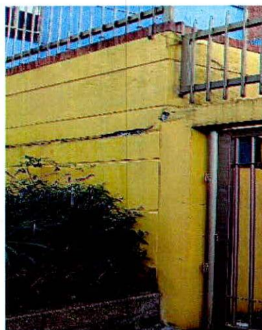
Fotografía 24. Daños identificados en el muro localizado al costado noroccidental del predio P2. (Fotografía tomada del diagnóstico técnico DI-18707)
