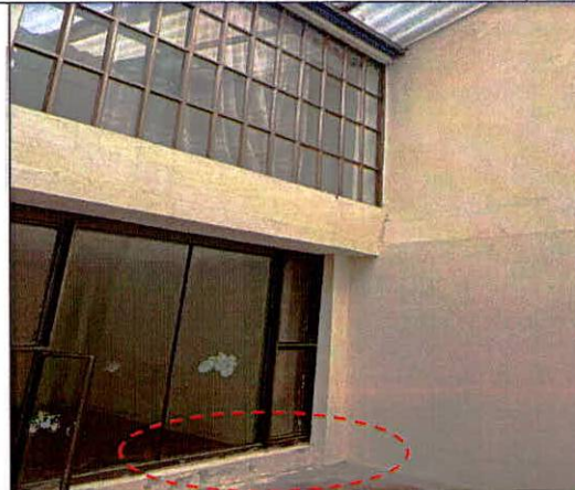
Foto 5. Humedades primer nivel P2
