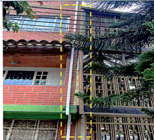
Foto 3. No se observa dilatación entre P1 y P2
