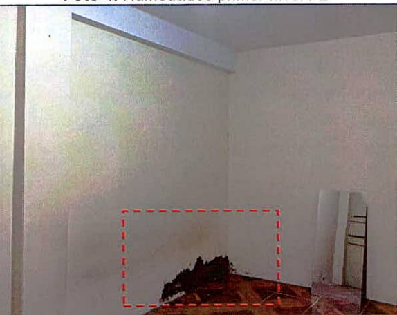
Foto 6. Humedades primer nivel P2
