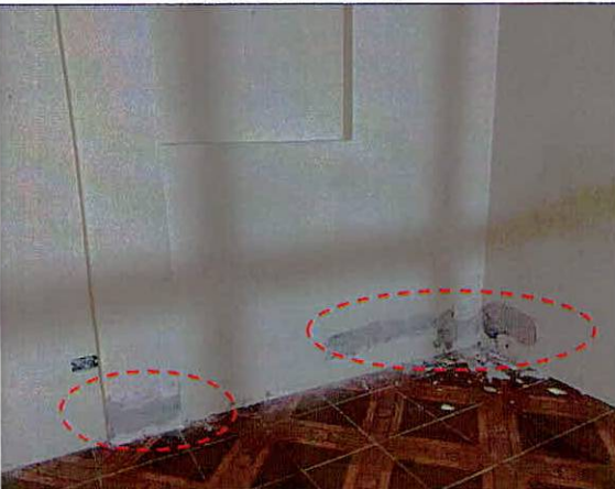
Foto 4. Humedades primer nivel P2
