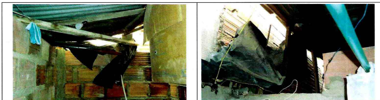
Fotografía 5 y 6. Vista de los daños del entramado en madera y las deficiencias constructivas que presenta.
