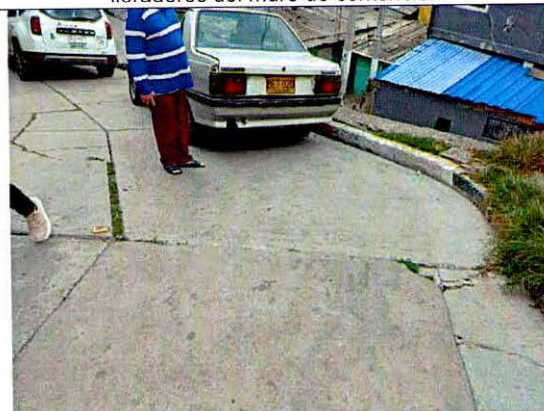
Fotografía 6. Leve hundimiento de las losas de concreto.
