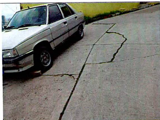
Fotografía 5. Fisuras sobre la vía de la KR 2C a la altura de la DG 163 BIS.
