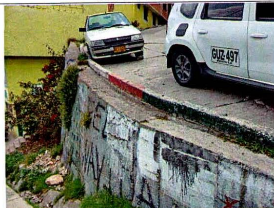
Fotografía 4. Crecimiento de material vegetal sobre fisuras y lloraderos del muro de contención.
