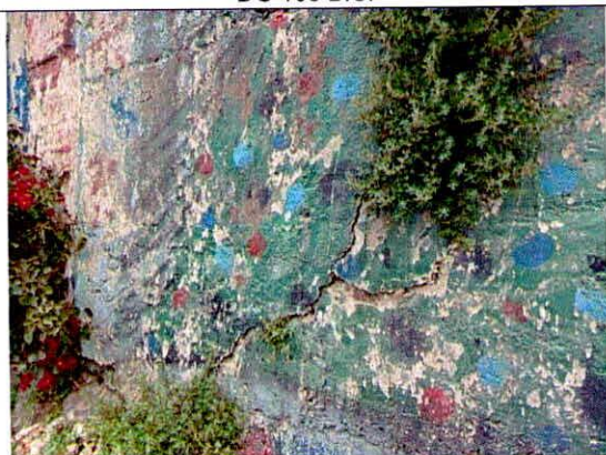
Fotografía 3. Fisuras en muro de contención.
