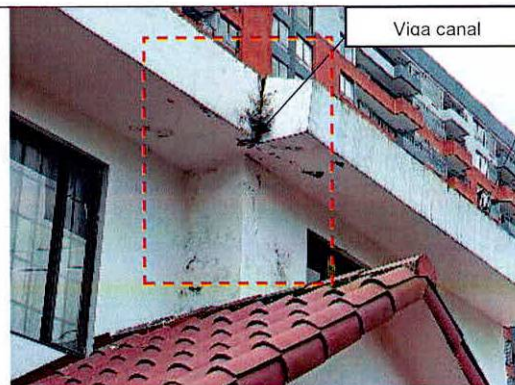
Fotografía 3. Sector donde se identifica la estructura de la vida canal de la vivienda evaluada.
