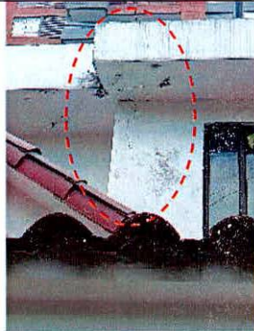
Fotografía 4. Manchas de humedad y filtraciones costado frontal de la vivienda.
