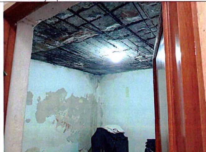
Fotografía 5. Desprendimiento total de capa inferior de concreto, exposición de aceros y humedad en muro perimetral occidental.
