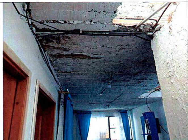
Fotografía 3. Desprendimientos parciales de capa inferior de concreto y exposición de aceros en zona de sala comedor.
