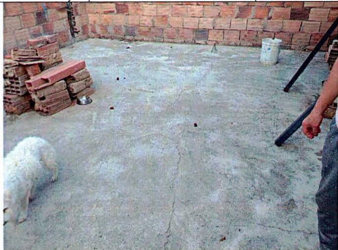
Fotografía 6. Fisura en zona de terraza sin medidas de impermeabilización.
