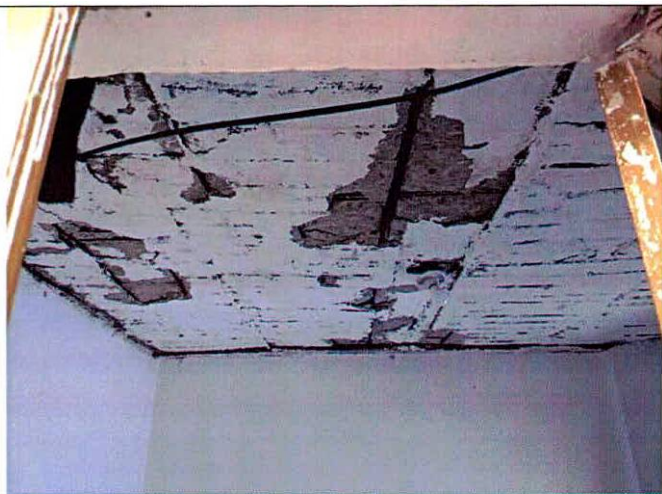
Fotografía 4. Desprendimientos parciales de capa inferior de concreto y exposición de aceros en habitación parte central.
