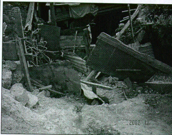
Foto No.4. Vista desde la parte superior del talud ubicado en el extremo posterior del predio visitado (costado oriental). En la parte media se observa la cicatriz de un antiguo movimiento superficial y al fondo la vivienda del predio vecino.
