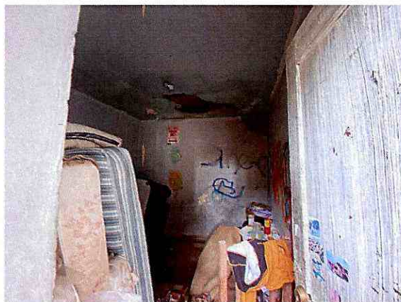
Fotografía 6. Vista de los daños que presenta la vivienda emplazada en el predio de la Calle 9 No. 2-30 Este (P2).
