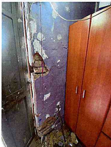
Fotografía 5. Vista de los daños que presenta la vivienda emplazada en el predio de la Calle 9 No. 2-28 Este (P1).
