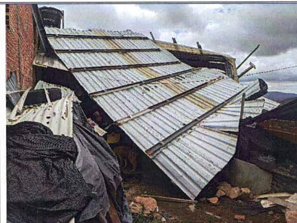
Fotografía No. 5. Vista de la cubierta de la vivienda de P3 que cayó sobre el patio de la vivienda del predio P1.
