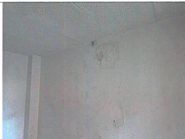
Fotografía 7 . Humedad en muros de mampostería reforzada del antiguo apartamento modelo
