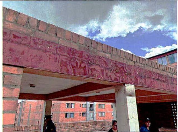
Fotografía 16. Fisuras de tendencia irregular en viga de la cubierta del salón comunal
