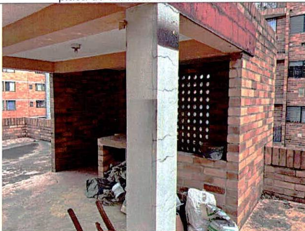
Fotografía 17. Fisuras de tendencia horizontal en columna de la cubierta del salón comunal
