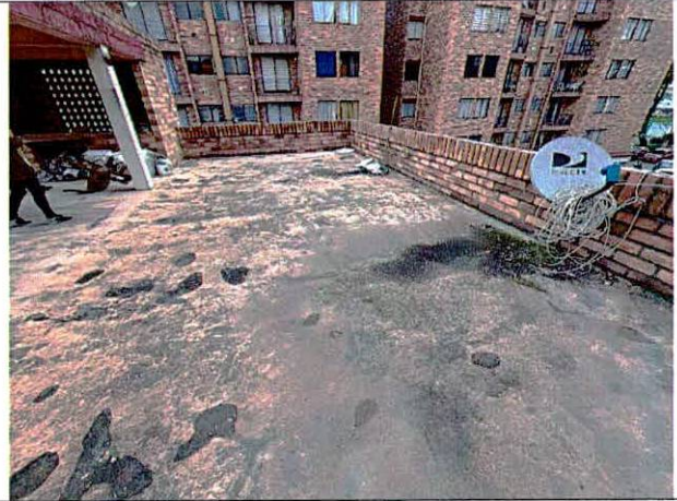
Fotografía 14. Vista general del estado de la cubierta del salón comunal
