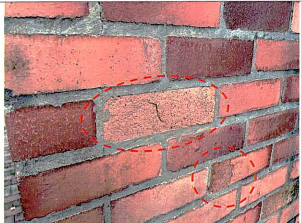
Fotografía 18. Degradación de mampuestos del salón comunal por presencia de humedad
