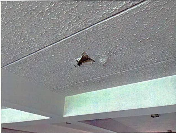
Fotografía 13. Desprendimiento de pintura en placa de cubierta del salón comunal
