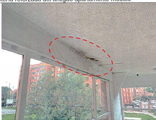
Fotografía 12. Humedad en placa de cubierta del salón comunal
