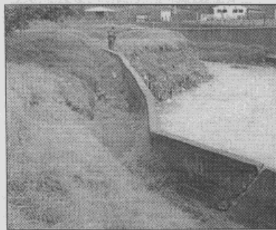
Fotografía 5 Detalle de grietas del muro del Sector 3
