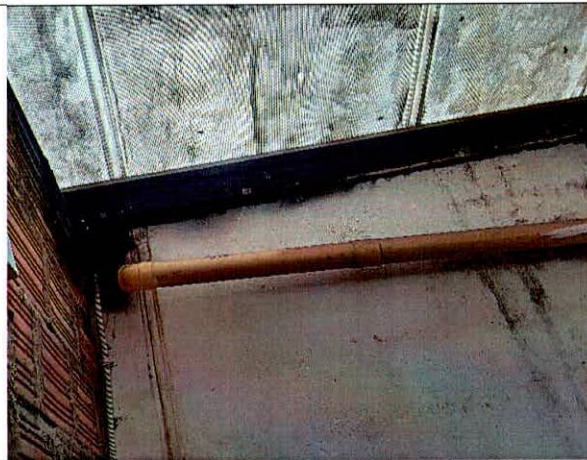
Fotografía 8. Tubería de gas afectada por la pérdida de revestimiento y daño en los accesorios.
