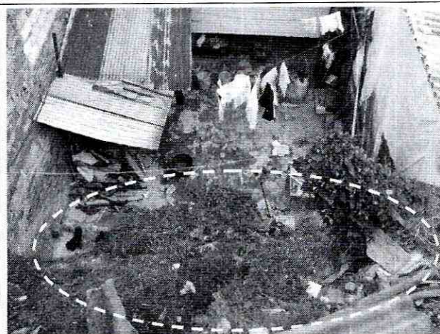
Foto 8. Vista del talud de corte, donde se presentó el proceso de remoción en masa, donde se evidencia que la masa movilizada se encuentra depositada en el patio posterior del predio de la Calle 32 Bis Sur No. 15-69 del Barrio Las Colinas. Tomada el día 12 de Septiembre de 2011.
