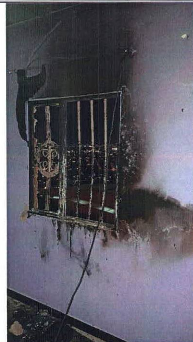
Fotografía 8. Muros de cerramiento de la vivienda del predio P1 alcanzados por el incendio. Se observa afectación en la ventaneria.
