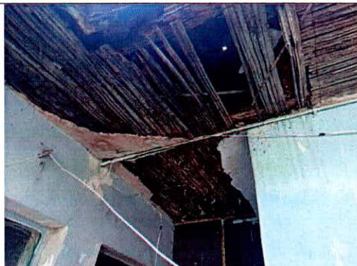
Fotografía 9. Daños en los elementos de tejado del costado posterior de la vivienda evaluada
