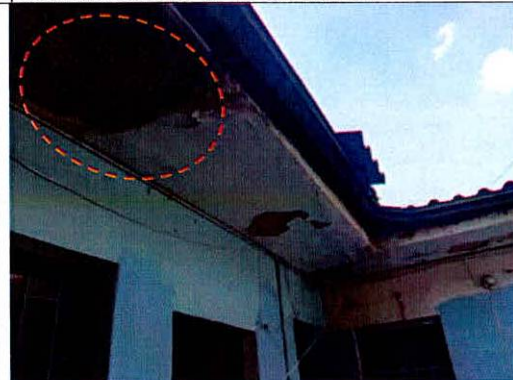
Fotografía 7. Daños en los elementos de tejado del costado posterior de la vivienda evaluada.
