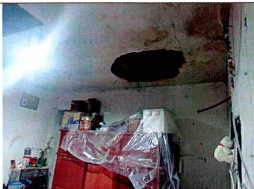
Fotografía 3. Daños en los elementos de cielo raso al interior de la vivienda.
