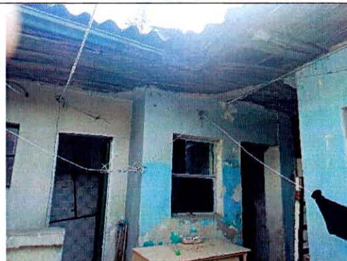
Fotografía 10. Daños en los elementos de tejado del costado posterior de la vivienda evaluada.
