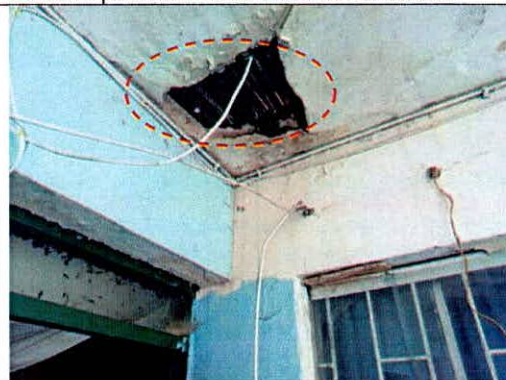
Fotografía 12. Daños en los elementos de tejado del costado posterior de la vivienda evaluada.
