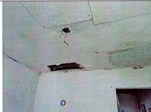
Fotografía 6. Agrietamientos y deformaciones en la placa de cubierta de la edificación.
