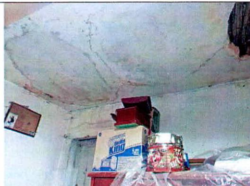
Fotografía 4 Daños en los elementos de cielo raso al interior de la vivienda.
