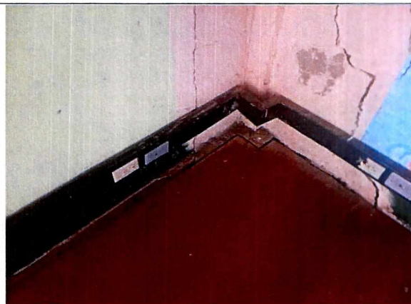
Foto 8. Grietas y dilataciones en la parte inferior de los muros de cerramiento en el extremo suroriental de la edificación.
