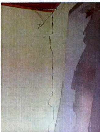
Foto 7. Dilatación vertical en muro de cerramiento al costado sur de la edificación evaluada.
