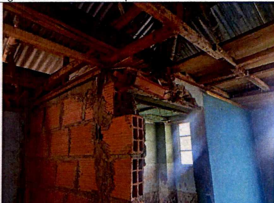
Foto 3. Zona habitable con daños y deterioro de los elementos de soporte de la cubierta.
