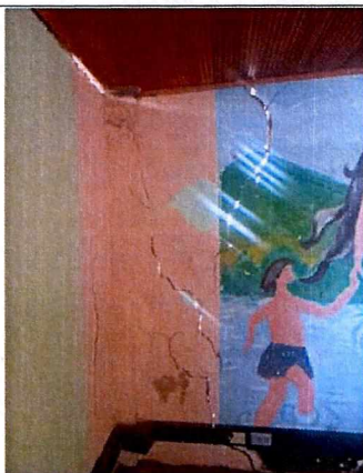
Foto 7. Patrón de grietas escalonadas en la esquina suroriental de la edificación evaluada.
