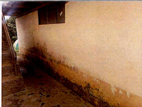
Foto 2. Humedades en la parte inferior del muro de cerramiento al costado norte de la edificación evaluada.
