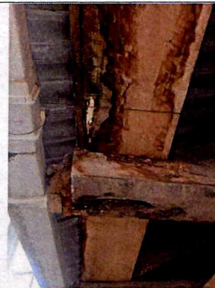
Foto 4. Deterioro, vetustez y humedades generalizadas en las varas de madera de soporte de la cubierta.
