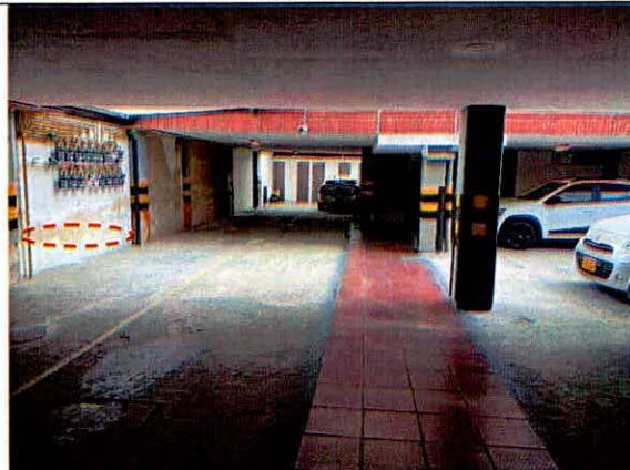
Fotografía 4. Manchas de humedad y desgaste en acabados en pintura del muro perimetral del costado sur de P1, sector primer nivel.
