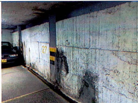
Fotografía 3. Manchas de humedad en el muro perimetral del costado sur de P1, sector sótano.
