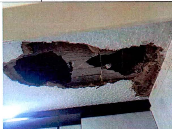
Fotografía 6. Desprendimiento de pañete en la parte inferior de la placa de entrepiso del apartamento 103 en la zona de la
