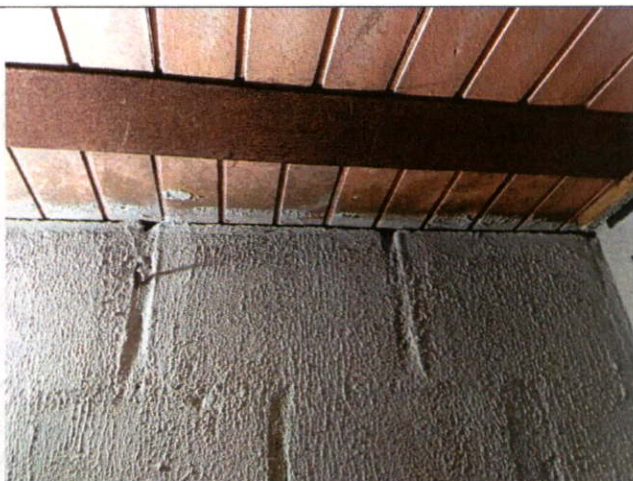
Fotografía 4. Humedad en losa de entrepiso.
