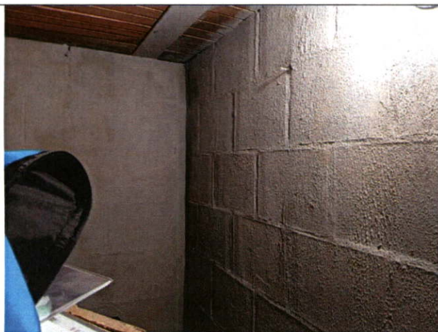
Fotografía 3. Humedad sobre muros divisorio y perimetral.
