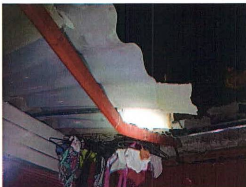
Fotografía 4. Daños identificados en el costado posterior de la vivienda que se emplaza en el predio P1.
