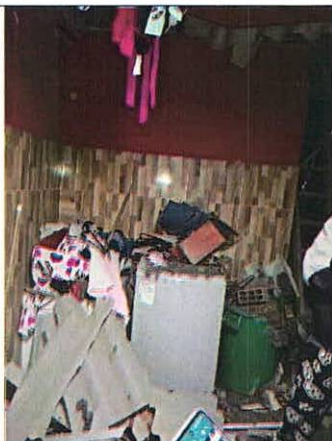
Fotografía 3. Daños identificados en el costado posterior de la vivienda que se emplaza en el predio P1.
