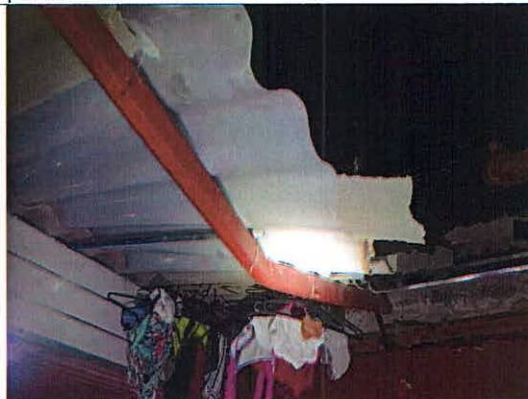
Fotografía 6. Cubierta afectada de la unidad sanitaria de la vivienda de P1.
