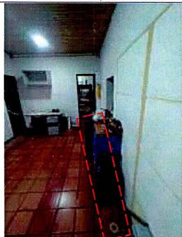
Fotografía 11. Muestra de hundimiento de contrapiso en borde occidental de "la casona"
