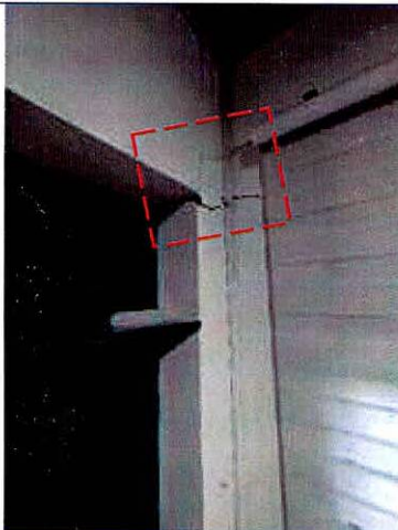
Fotografía 7. Grieta en intersección muro perimetral norte y muro divisorio
