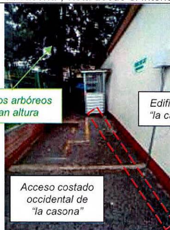
Fotografía 12. Muestra de fracturamiento del pavimento al costado occidental de "la casona"
