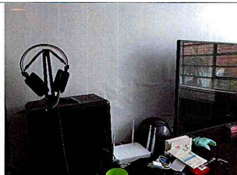
Fotografía 4. Humedades al interior del apartamento 101 en el predio P1, en el Sector Catastral San Luis.
