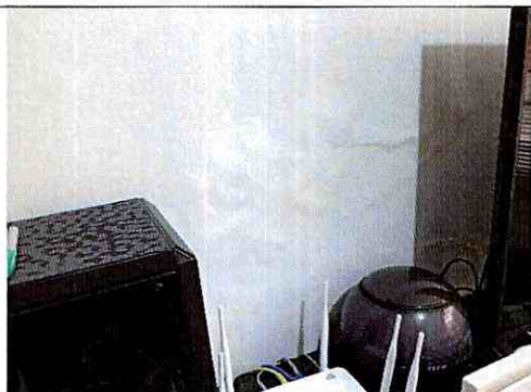
Fotografía 5. Humedades al interior del apartamento 101 en el predio P1, en el Sector Catastral San Luis.
