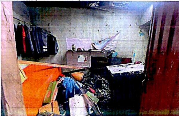
Fotografía 3. Daños evidenciados en el primer nivel
