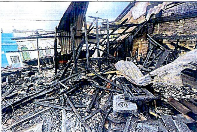
Fotografía 5. Daños evidenciados en el segundo nivel
