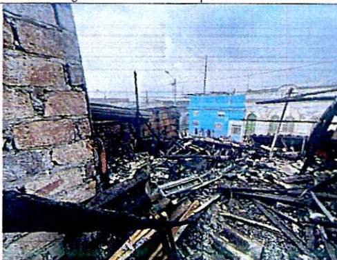
Fotografía 4. Daños evidenciados en el segundo nivel
