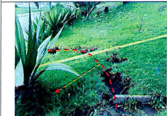
Fotografía 10. Escarpe identificado en el talud de corte vial verificado.
