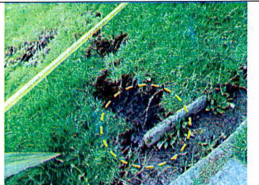
Fotografía 11. Saturación del talud por aportes de tubería de acueducto.
