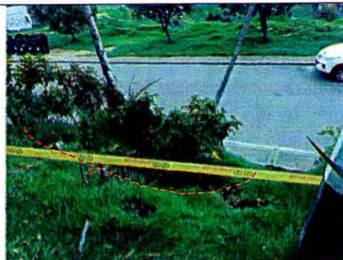
Fotografía 9. Escarpe identificado en el talud de corte vial verificado.
