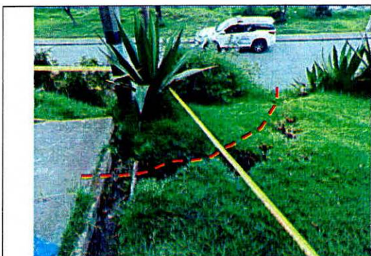
Fotografía 8. Escarpe identificado en el talud de corte vial verificado.
