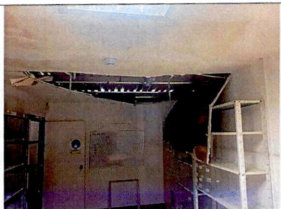
Fotografía 3. Colapso parcial del cielo raso, oficina al costado norte del tercer nivel.
