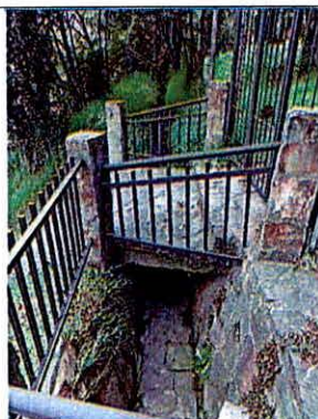
Fotografía 6. Acceso peatonal CL 121 costado occidental del talud evaluado. Condiciones evidenciadas en noviembre de 2020 (Tomado DI-15103)
