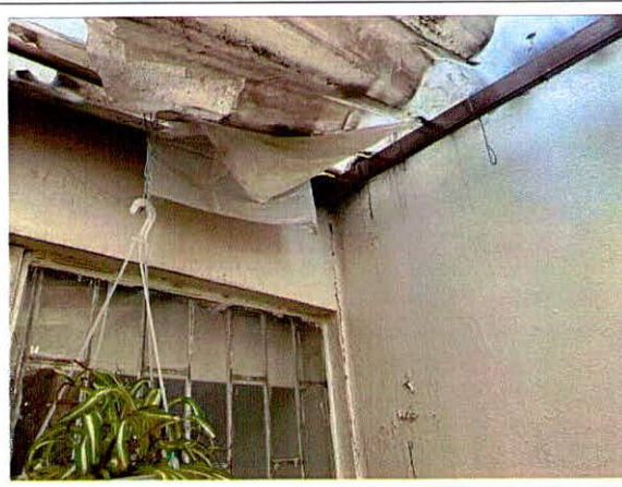
Fotografía 4. Fisuras y húmedas en la vivienda de P1, sector patio de ropas.
