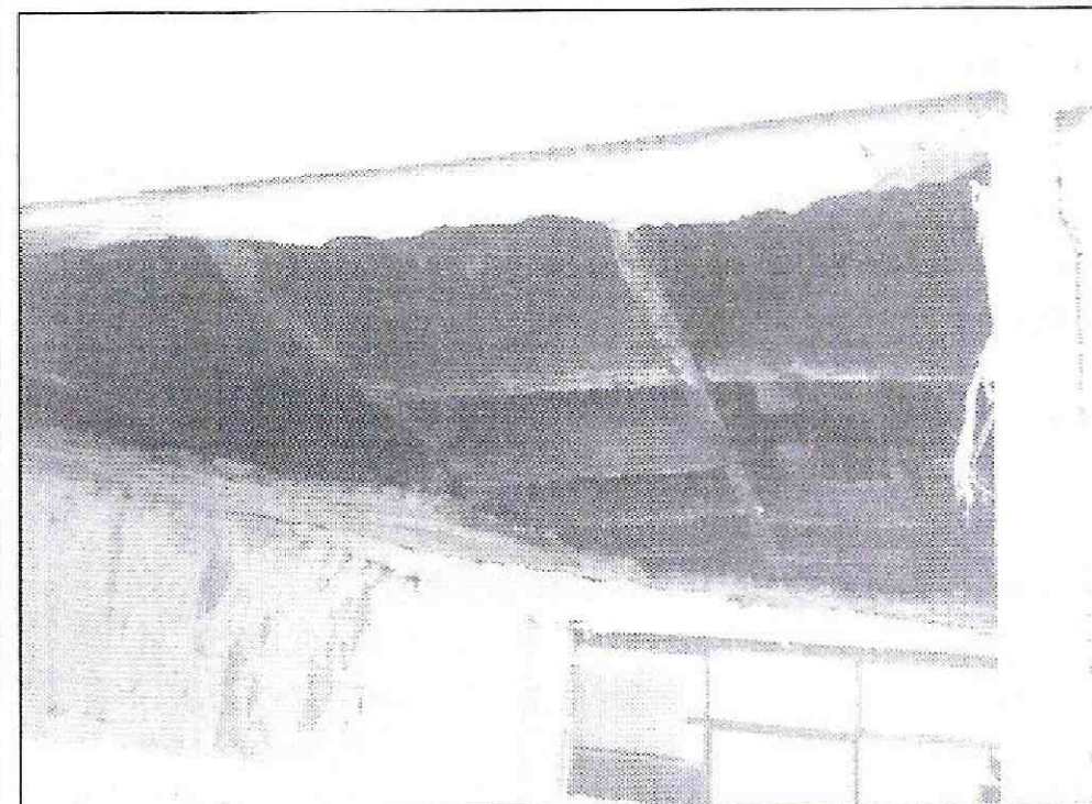
Fotografía 5. Pérdida de cielos rasos y deterioro de elementos de madera que conforman la placa de entrepiso de la edificación ubicada al costado Norte y Oriente del predio de la Calle 6D No. 3-67 Este, en el barrio el Guavio de la localidad de Santa Fe.
