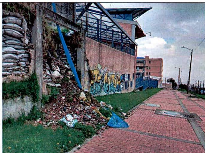
Fotografía 4. Colapso parcial de modulo ubicado al costado norte del muro de contención.
