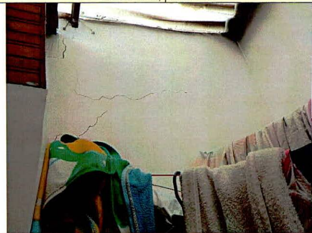
Fotografía 8. Fisuras en muro perimetral tercer nivel, predio P3.
