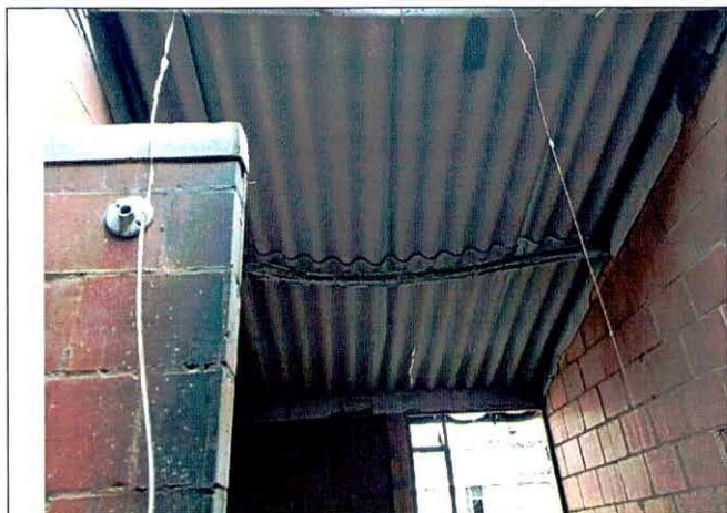
Fotografía 3. Grieta y deflexión de elemento de soporte de cubierta. Desprendimientos de recubrimiento de muros, Predio P1.
