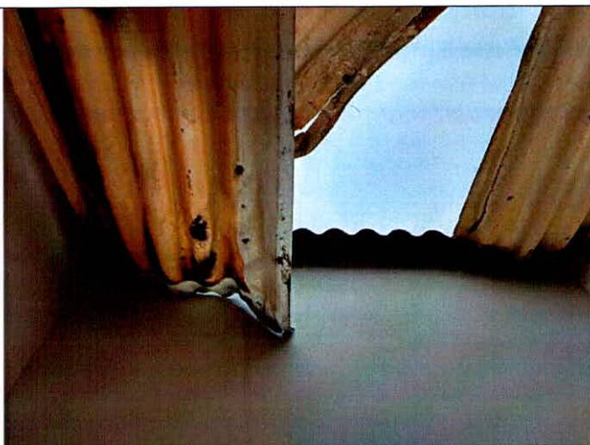
Fotografía 10. Derretimiento de tejas en poliuretano, tercer nivel, predio P4.
