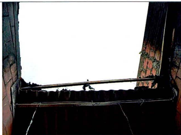
Fotografía 4. Derretimiento de cubierta en poliuretano, predio P1.
