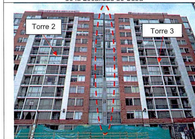
Fotografía 3. Inclinación de las edificaciones y junta de dilatación sísmica entre torres 2 y 3
