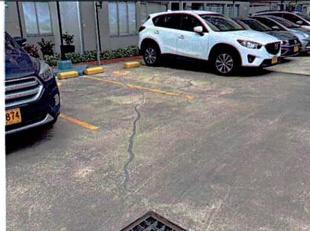
Fotografía 12. Fisuras en cara superior de la placa de la plataforma de parqueaderos
