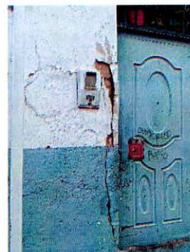
Fotografía 22. Daño en muro de fachada predio P4.
