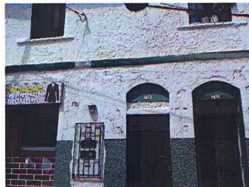
Fotografías 14 y 15. Fachada predio P6.
