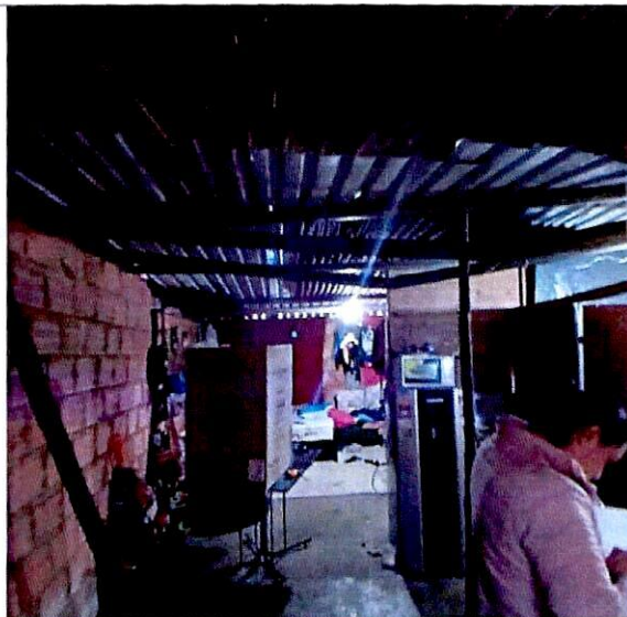
Fotografía 3. Muestra de deformación de correas de cubierta de la vivienda evaluada
