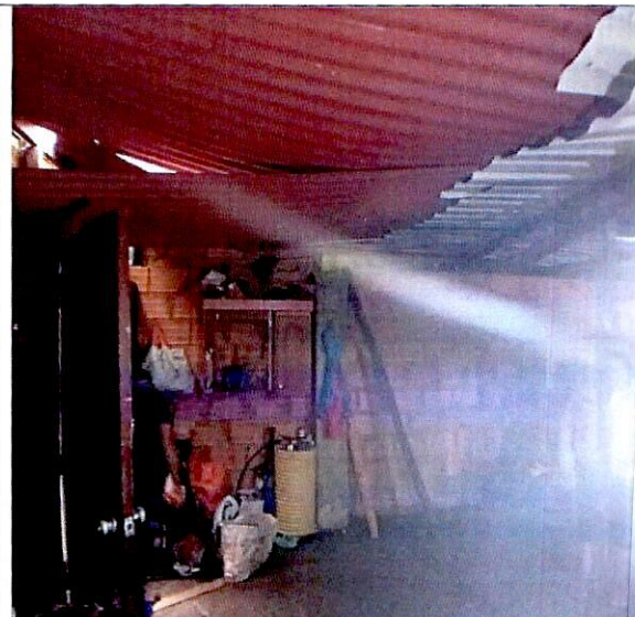
Fotografía 4. Muestra de deformación de tejas de cubierta de la vivienda evaluada
