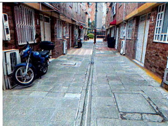
Fotografía 10. Adoquines en concreto desprendidos.
