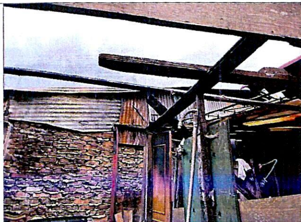
Fotografía 7. Elementos de madera inestables en la cubierta de V1
