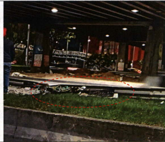
Fotografía 4. Desprendimientos de fragmentos de la vigueta
