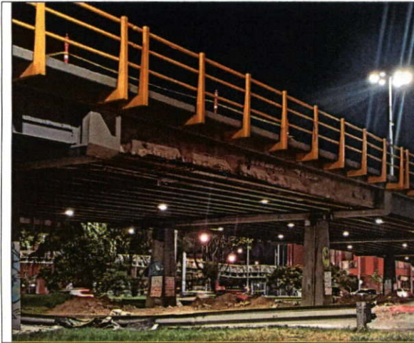
Fotografía 3. Afectaciones a las viguetas del vano intermedio del puente
