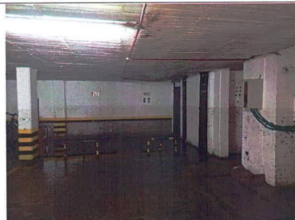
Fotografía 5. Humedad en la cara inferior de la losa de entripiso, subnivel 3.
