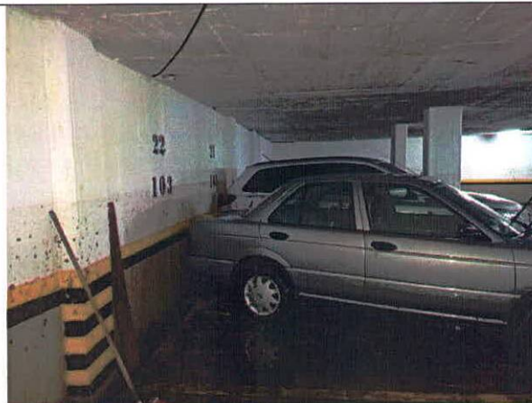
Fotografía 4. Marca de la lámina de agua en el subnivel 3 de parqueaderos.
