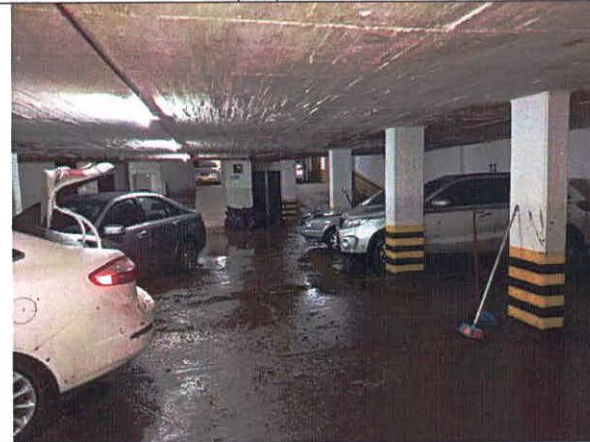
Fotografía 6. Estado general del subnivel 3 de parqueadero.
