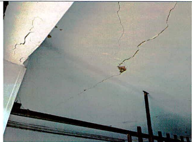
Grieta longitudinal en losa de entpiso del segundo nivel, vista desde el primer nivel
