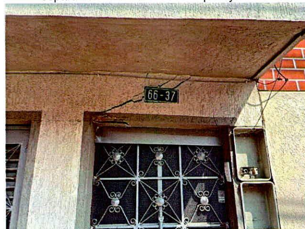
Grieta en dintel del acceso a la edificación
