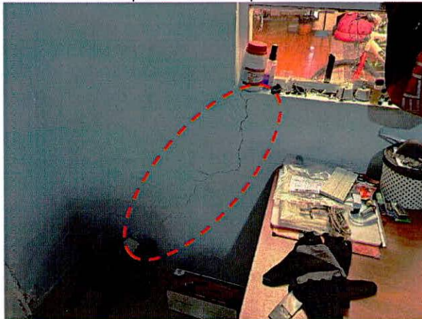
Grieta de aprox. 2mm de abertura en muro de la habitación del costado posterior del predio
