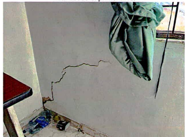
Grietas en muros de fachada del apartamento del segundo nivel
