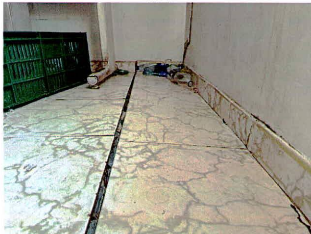
Deformación en placa de entpiso y daños en acabados del apartamento del segundo nivel
