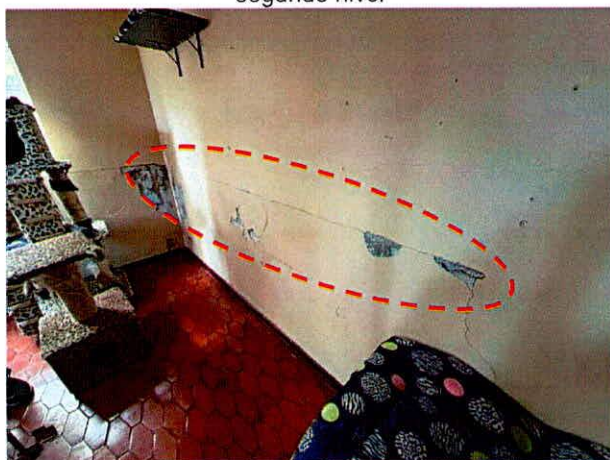
Grieta de aprox. 1mm de abertura en muro de la habitación del costado posterior del segundo nivel
