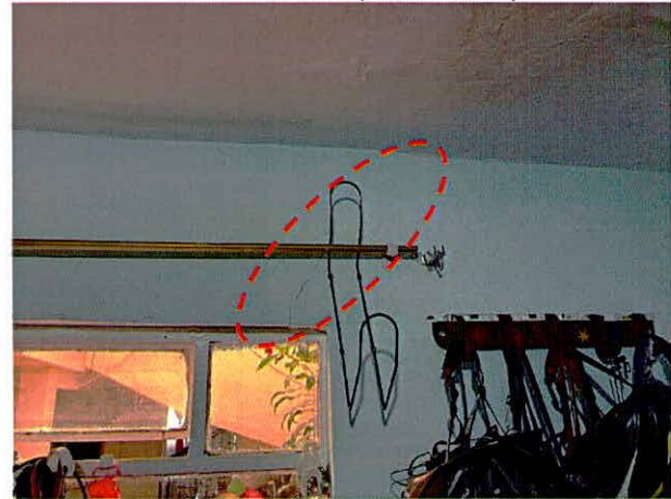
Grieta de aprox. 1.5mm de abertura en muro de la habitación del costado posterior del predio
