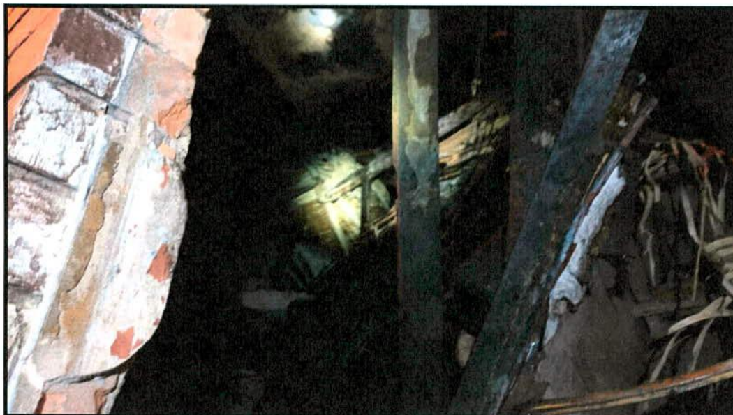
Fotografía 2. Colapso de la cubierta del predio de la Carrera 5 No 2-60 en la Localidad de Santa Fé
