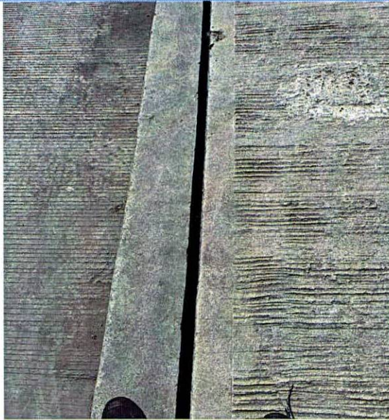
Fotografía 13. Abertura entre bordillo y andén de aproximadamente 3 cm, andén costado occidental a la vía TV 6 B Este.
