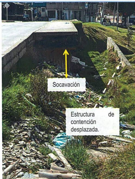
Fotografía 11. Socavación estructura de soporte y desplazamiento estructura de contención.
