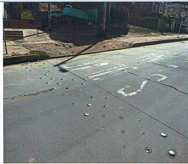
Fotografía 4. Fisura sobre capa de rodadura vía TV 6B Este.
