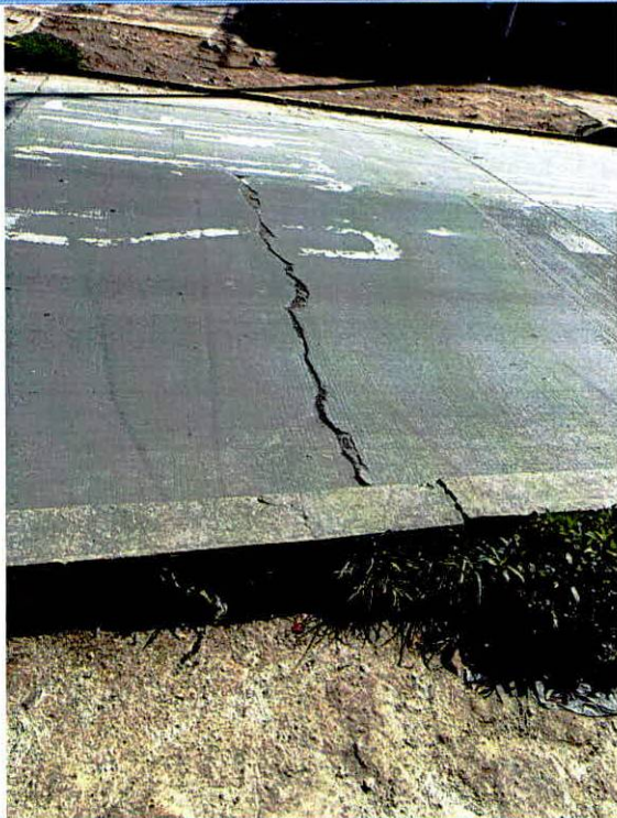
Fotografía 5. Fractura transversal de la losa en concreto de la vía TV 6B Este.
