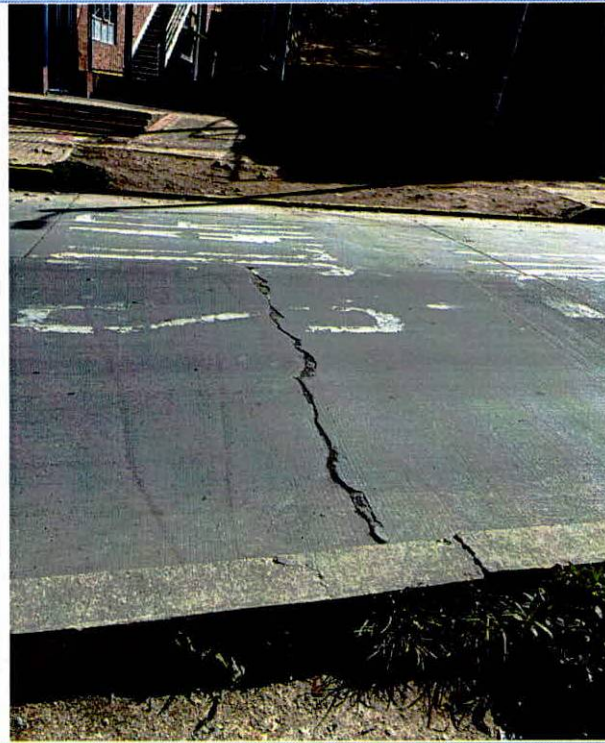
Fotografía 6. Fractura transversal de la losa hasta el bordillo en concreto de la vía TV 6B Este.
