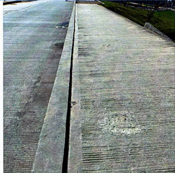
Fotografía 14. Abertura entre bordillo y andén por sobre todo el andén en concreto.
