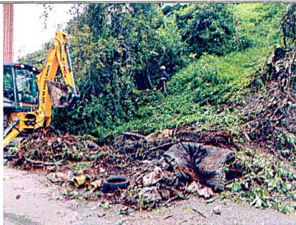
Fotografía 13. Movimiento del material que obstruye la vía de la calle 62 (30/05/2024)
