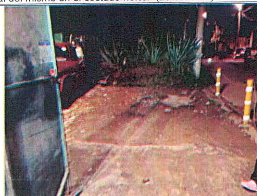
Fotografía 10. Zona verde tiene como uso el parqueo de vehículos ubicado en la corona del talud. (29/05/2024)
