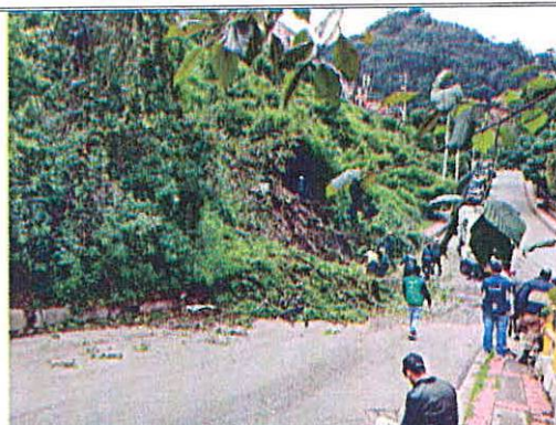
Fotografía 12. Limpieza, remoción y habilitación del material depositado sobre la vía de la calle (30/05/2024)
